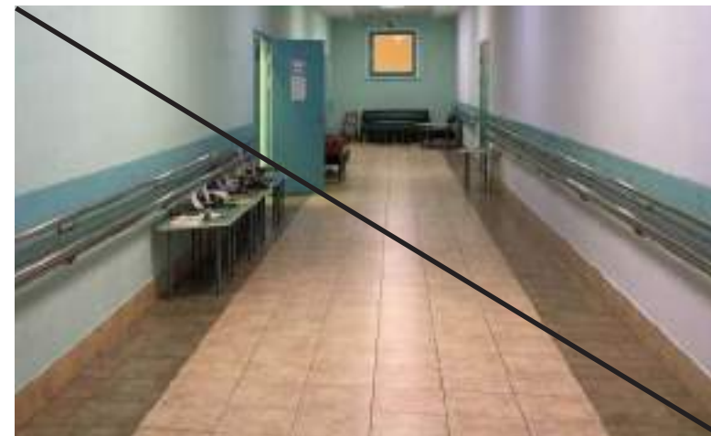
Плохо Керамогранитная плитка с крупными швами
