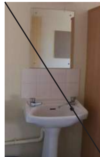
Плохо Раковина с пьедесталом. Фартук из плитки
