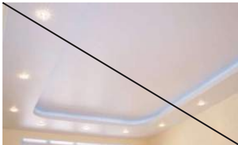
Плохо Многоуровневые гипсокартонные конструкции
